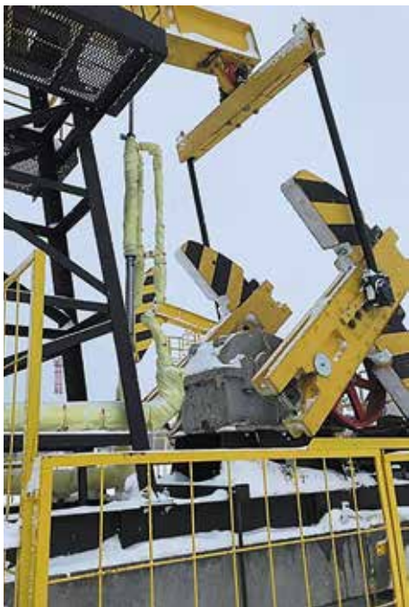
Насос УНГБ на скважинной насосной установке
